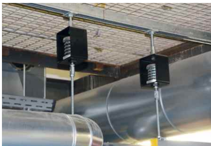
Entkoppelte Rohrleitungen mit Isotop® SD/Z
